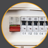
Cajas de fusibles
